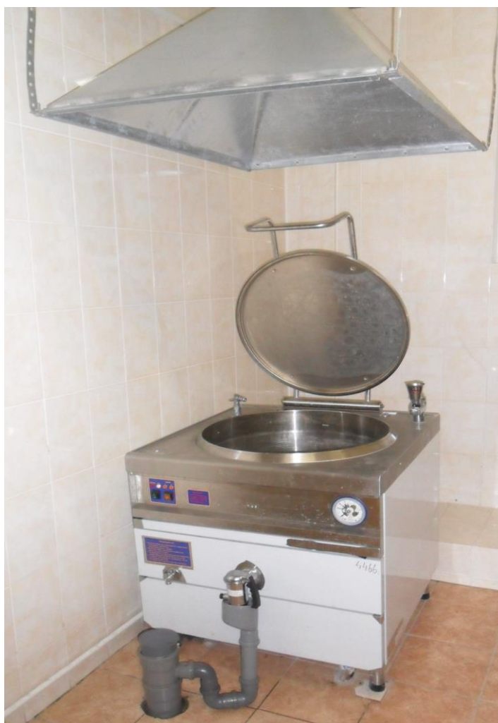
Рисунок 1. – Варочный котел с вытяжной вентиляцией
